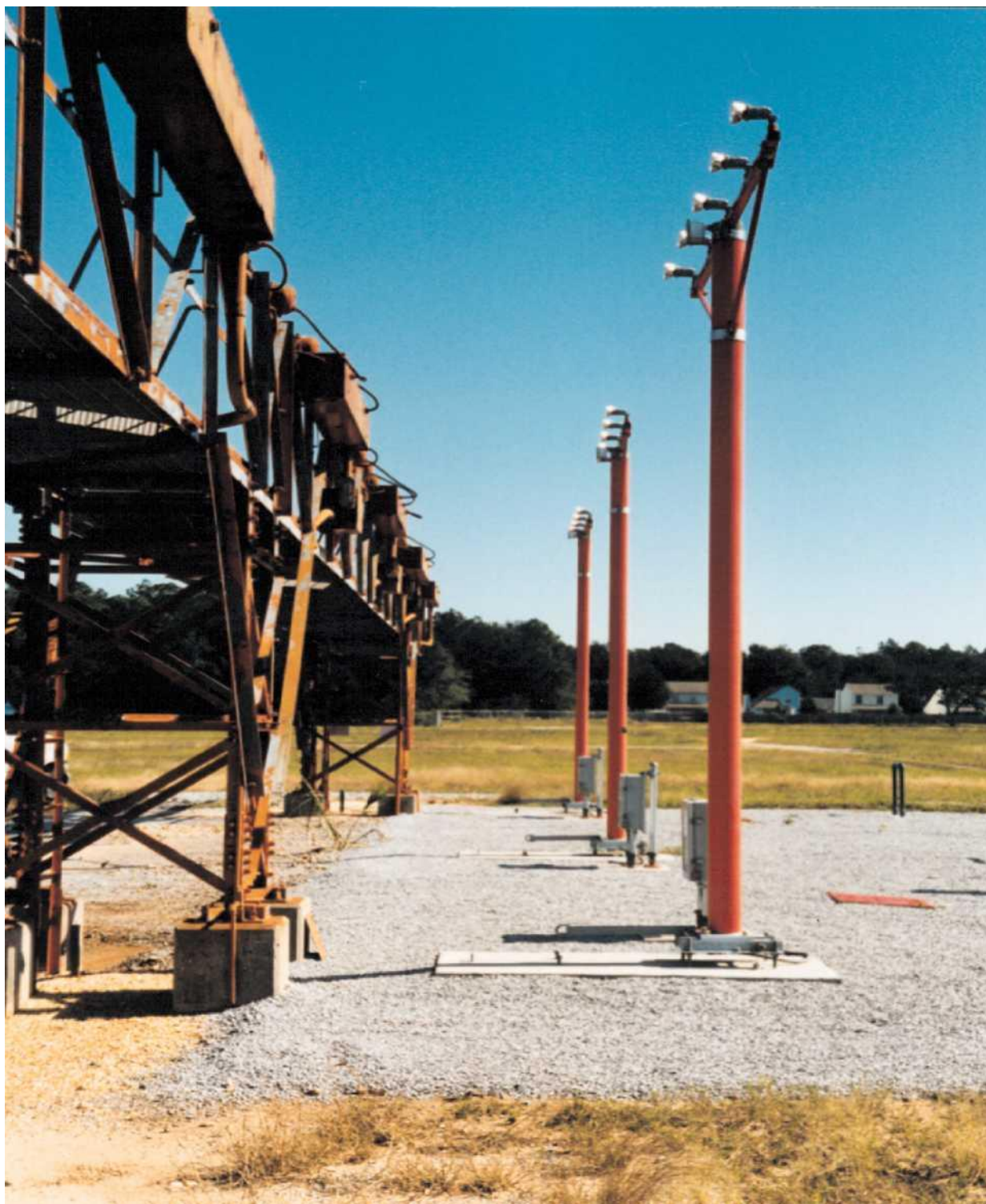
Рисунок 4-6. Установка огней приближения жесткой конструкции (слева), заменяемая новыми ломкими конструкциями (справа)
