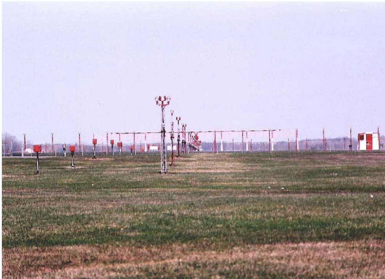
Рисунок 4-4. Опоры огней приближения – алюминиевые решетчатые конструкции
